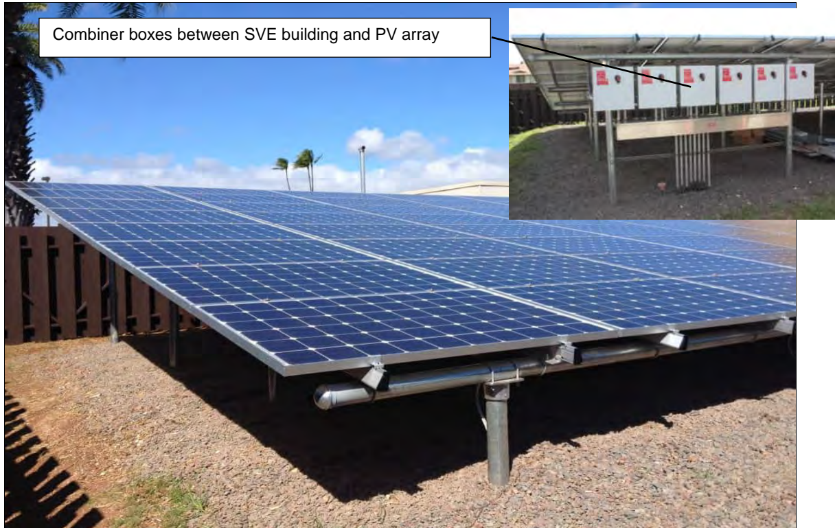
Photo 11. 72-panel PV array
